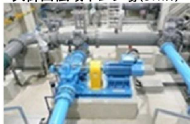
久御山広域ポンプ場(31kW)
