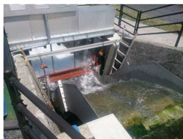
小水力発電施設
