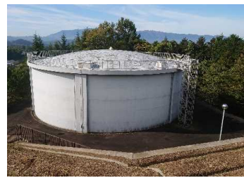
高家配水池 出典: 奈良県より提供
