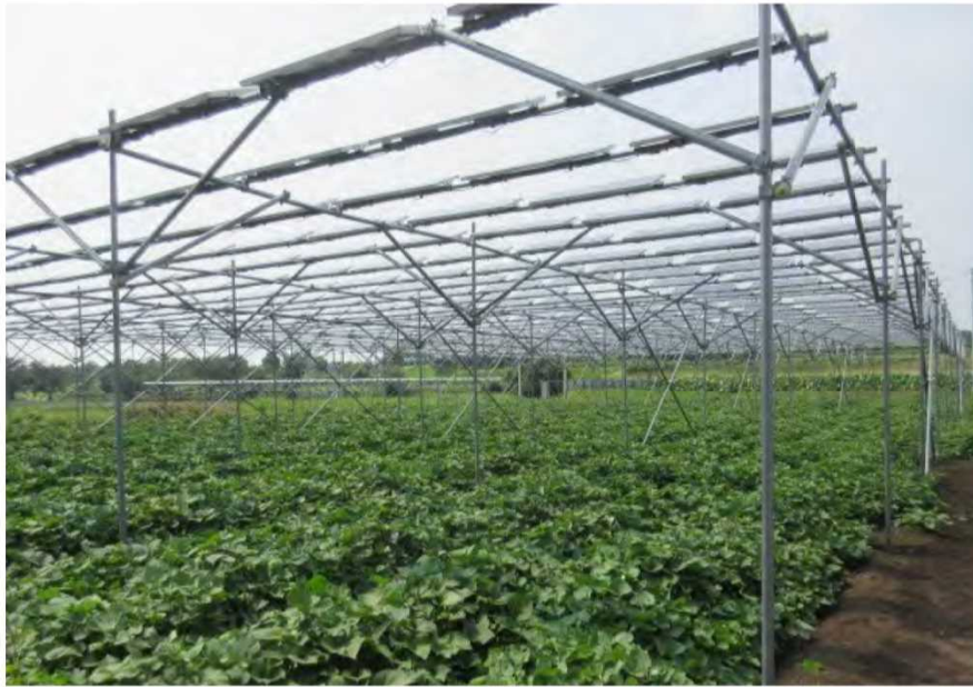
露地の畑の上部にパネルを設置
