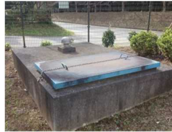
神崎町水道 古原浄水場水源1号井
