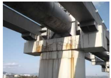
水管橋 橋脚のひび割れ
