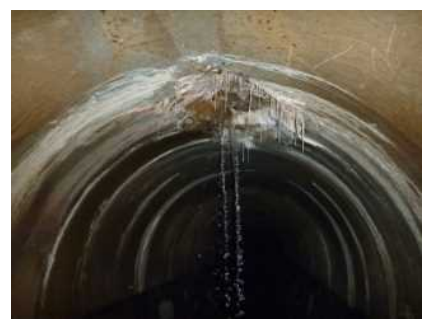
トンネル天頂部の欠損
