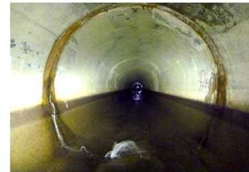
トンネルの内部状況 (継ぎ目からの地下水吹出し)
