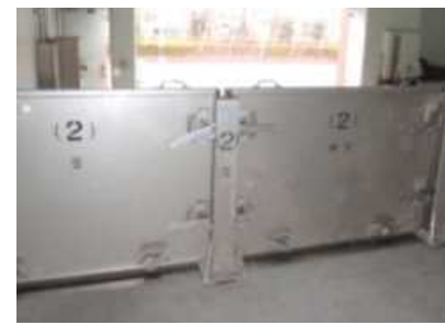
止水板(葛西給水所)
