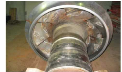
ポンプ羽根車の壊食状況
