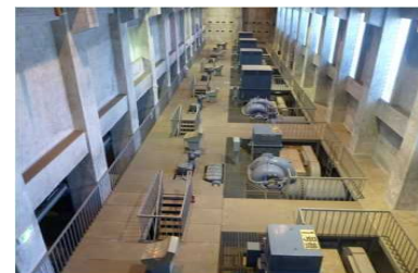
老朽化した横芝揚水機場
