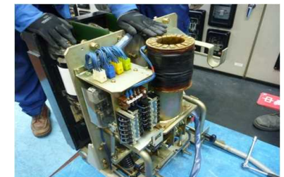
電気設備の焼損状況
