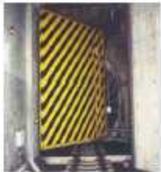
防水扉(トンネル内)
