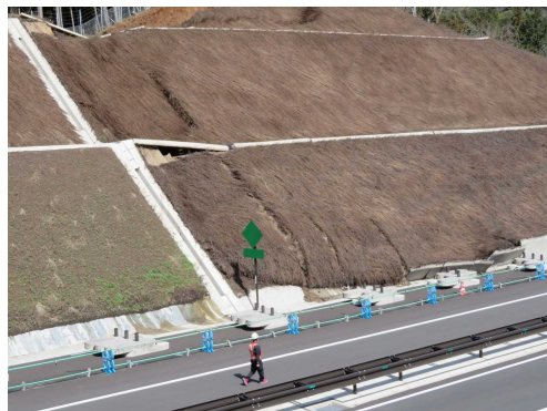
■国道483号日高豊岡南道路:切土部 令和3年3月18日発生(令和2年(2020年)11月開通) ※施工中に、近傍(約200m)で被災した事象あり
