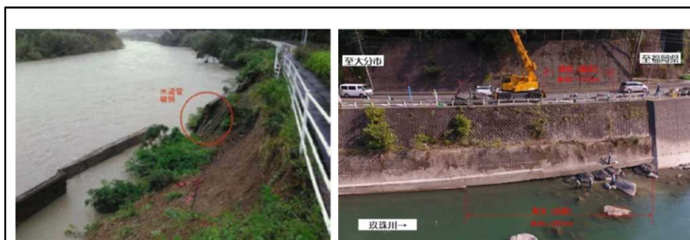
擁壁等における洗掘による変状事例
