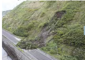
【国道232号 法面崩壊状況】
