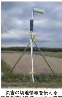
災害の切迫情報を伝える簡易型河川監視カメラの設置(常呂川)
