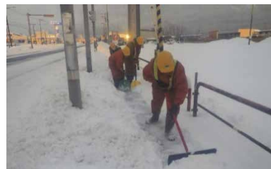
電柱により歩道が狭い箇所は人力で除雪するため作業効率が低下 (苫小牧市 国道36号)
