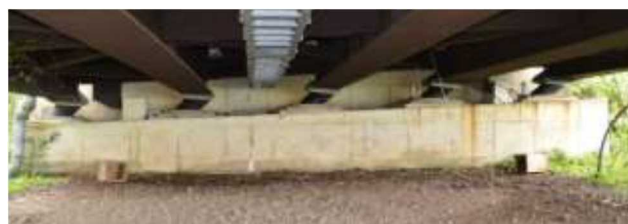
図-解 4.1.4 橋近傍での断層運動に伴う地盤変位により下部構造が動いた事例
