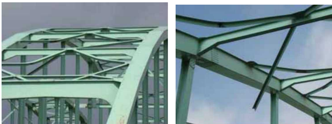
図-解 4.1.1 上弦材が座屈、破断した例（国道 45 号 天王橋）
