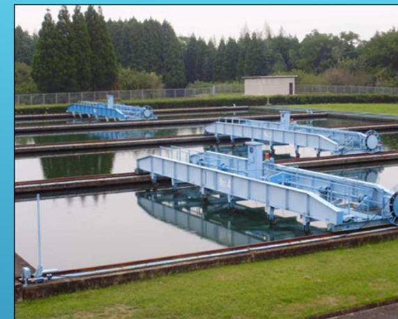
浄水施設（上の原浄水場） （提供：熊本県企業局）
