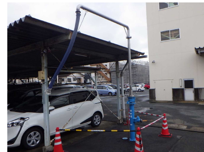
拠点給水設備(久留米市企業局敷地内)
