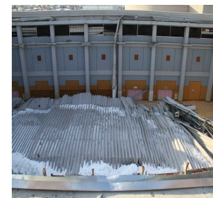
体育館の屋根崩落被害(埼玉県)
