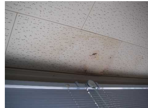
3階植物防疫所出張所事務室:天井から漏水している
