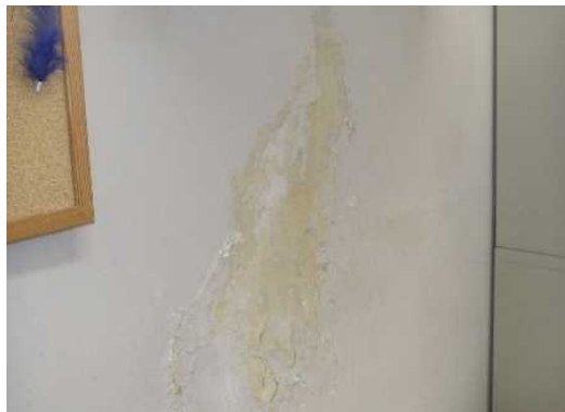
3階海上保安署事務室:ひび割れから錆汁が発生している
