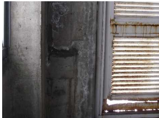
1階機械室:建具が腐食している
