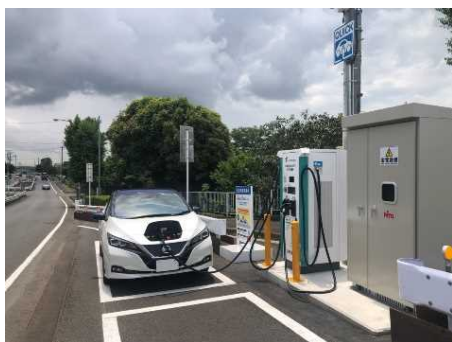
公道に設置されたEV充電施設(横浜市)
