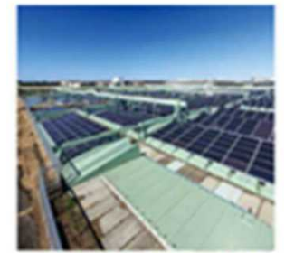
下水処理場の上部空間を活用した太陽光発電
