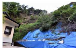
豪雨の度に土砂崩れが多発
