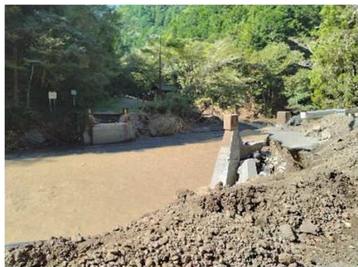
橋りょう損壊
