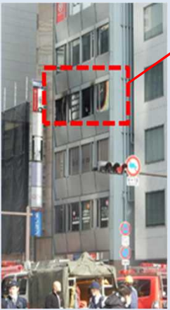
【火災建築物 外観】
