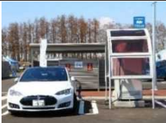
急速EV充電施設の設置状況(道の駅「おとふけ」)
