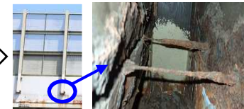
鋼製高欄内部の腐食 (16号大阪港線)
