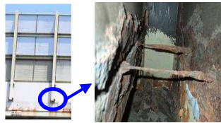
投棄防止柵支柱のアンカー部の減肉 (16号大阪港線 阿波座付近)
