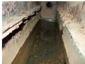
高欄内の滞水 (3号神戸線 府県境付近)
