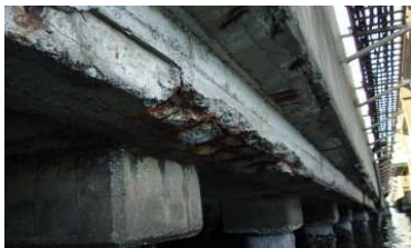
コンクリート桁の剥離・鉄筋腐食
