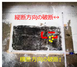
PC鋼材の破断
