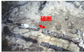
舗装面をはつり撤去し、 内部のPC鋼材の破断を発見
