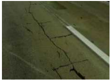
舗装面のひび割れを発見 (2016(H28).12)
