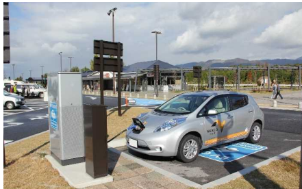
SAでのEV充電(多賀SA)
