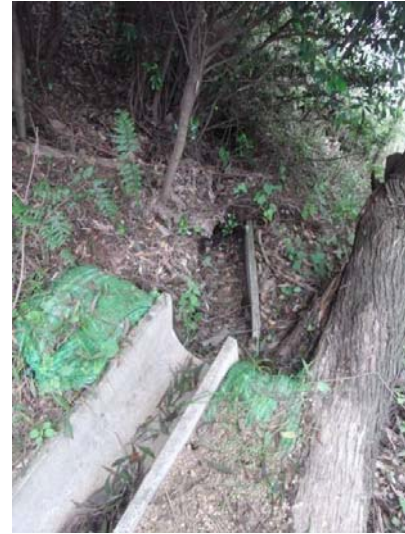
写真 排水溝の破損の例
