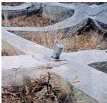
写真 受圧構造物の破損の例
