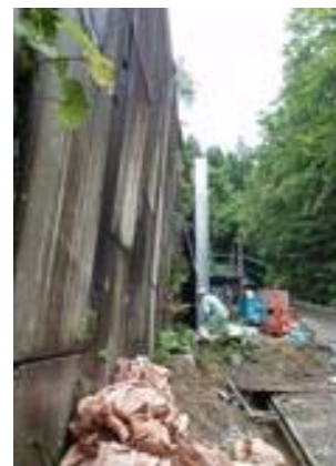
写真 壁面の傾斜の例
