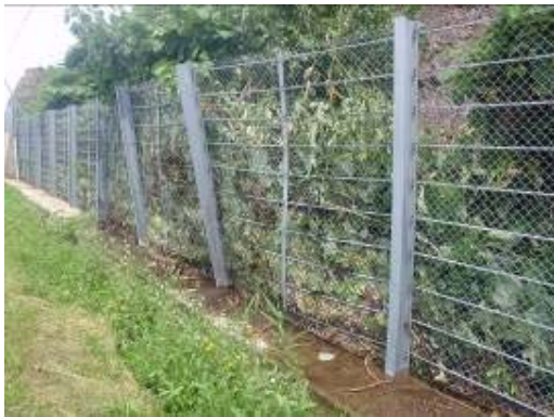
写真 落石防護柵の傾動の例
