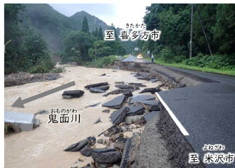
【R4.8月】国道121号 道路流失 (山形県米沢市)
