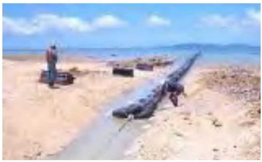
沖縄の小規模離島を結ぶ海底送電ケーブルの整備等を支援
