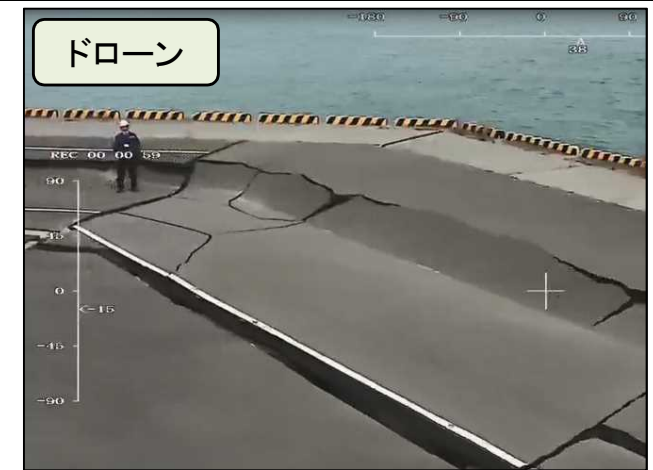
福島県沖を震源とする地震(R4.4) ドローンによる被災状況調査(相馬港)
