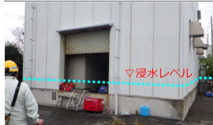
電源施設の浸水
