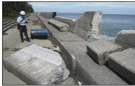
高波による護岸倒壊（神奈川県横浜市）
