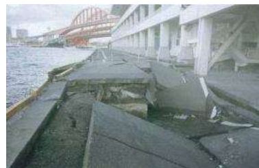
岸壁の被災(神戸港)
