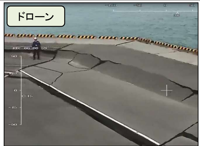
福島県沖を震源とする地震(R4.4) ドローンによる被災状況調査(相馬港)
