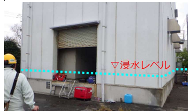
電源施設の浸水
