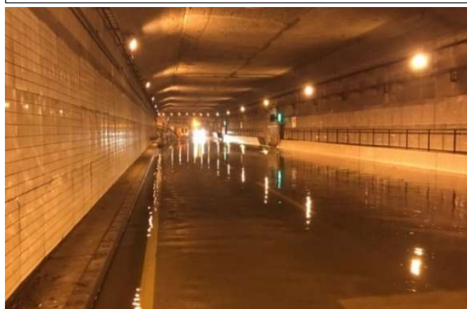
トンネルの冠水
