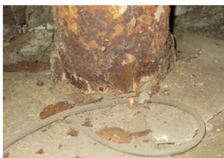
柱材の腐食状況
