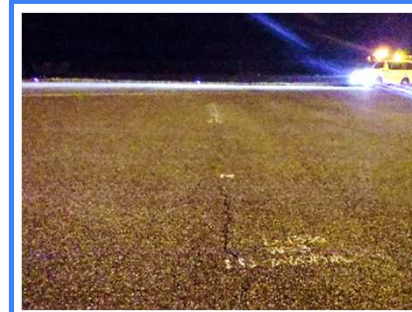
誘導路C10付近：ひび割れ
