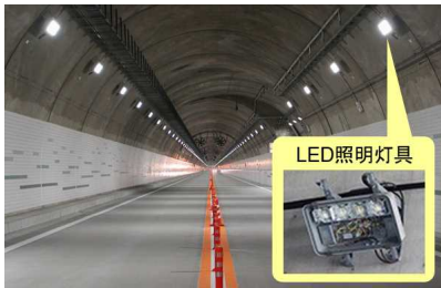
道路照明のLED化
