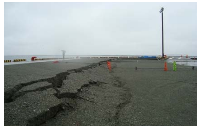
【福島県沖地震による相馬港の被害】
