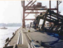
兵庫県南部地震の被害
