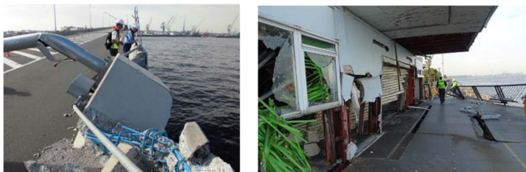
図 1.5.4 台風第15号被災調査の様子
