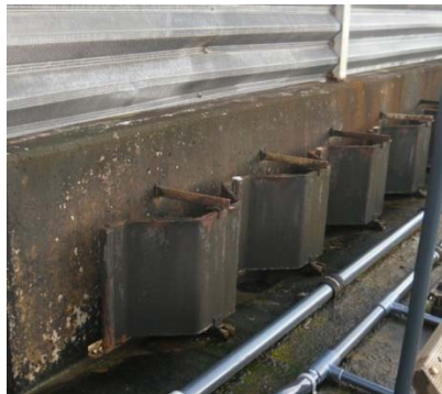
図 1.3.B39 ハット型鋼矢板に関する暴露試験 (10 年経過)
