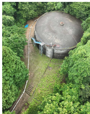
貯水タンクと送水管 「男鹿市HP」より
