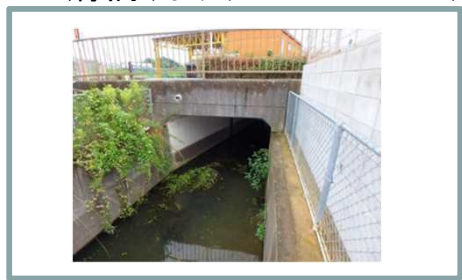
■ 溝橋(ボックスカルバート)
