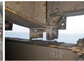
▲シェッド主梁端部破断
