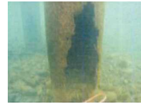
▲橋脚水中部の断面欠損
