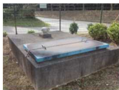
神崎町水道 古原浄水場水源1号井 【出典】千葉県より提供
