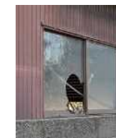
窓が割れた管理不全空家
