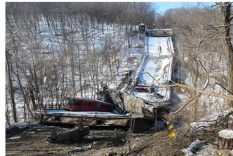
フーン・ホロ橋崩落 (2022年) (国家運輸安全委員会 (NTSB) HPより)
