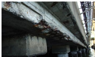
コンクリート桁の剥離・鉄筋腐食
