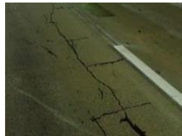
路面のひび割れ
