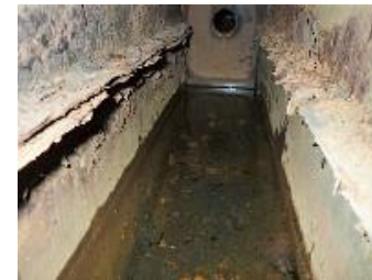
高欄内の滞水 (3号神戸線 府県境付近)
