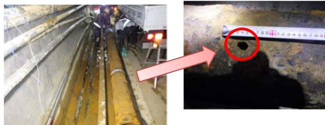
劣化した消火用配管の損傷状況
