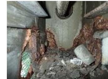
高欄内部の著しい断面欠損・発錆 (11号池田線 梅田付近)
