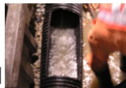
【排水管内の遊離石灰堆積状況】
