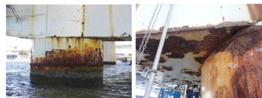
鋼製橋脚腐食
