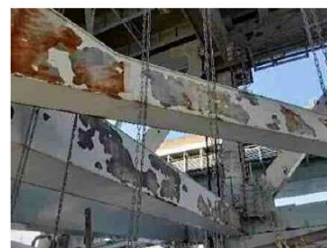
塗膜のはく離・腐食
