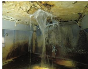
構造目地の漏水
