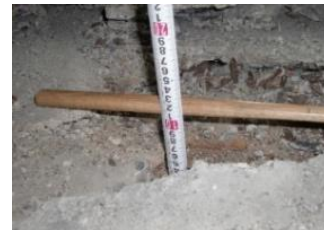
中床版上面のコンクリートはく離
