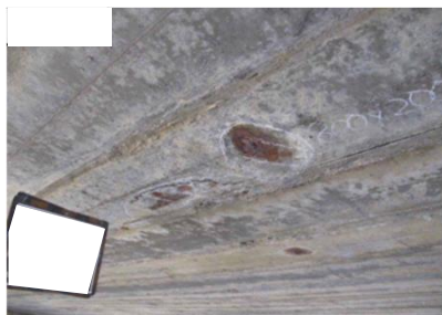
※写真はPC桁下面の損傷事例
