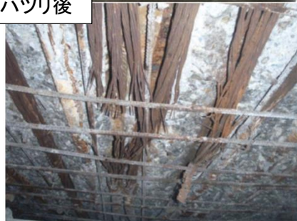
※写真はPC桁下面のひびわれ事例
