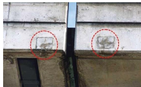
写真 2.4 ひび割れ、漏水 (定着部)
