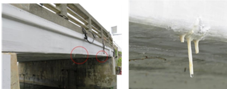
写真 2.6 補強材からの漏水の例
