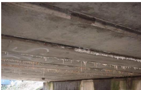
写真 2.3 遊離石灰 (間詰め部)
