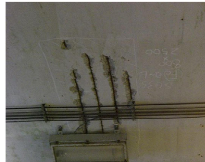
付写真-3.1.2 鋼材腐食の例
