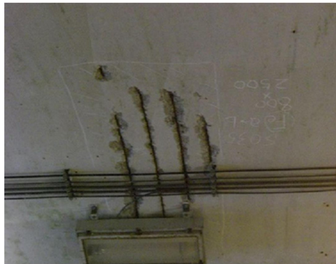
付写真-3.1.2 鋼材腐食の例
