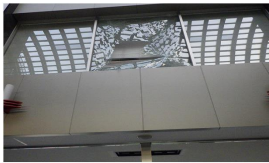
ターミナルビル内ガラス破損
