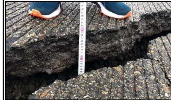
滑走路のひび割れ
