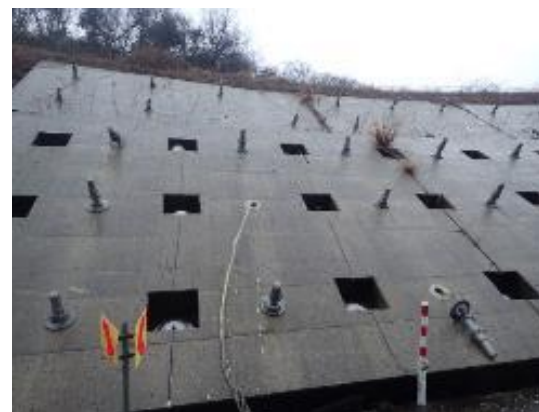
R6被災状況: グラウンドアンカーの破損(飛び出し)
