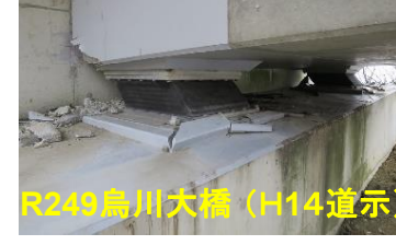
ゴム支承の残留変形
