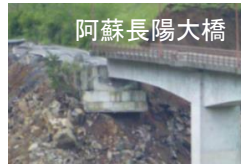
阿蘇長陽大橋 斜面変状による橋台の沈下
