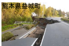
熊本県益城町 盛土の崩壊
