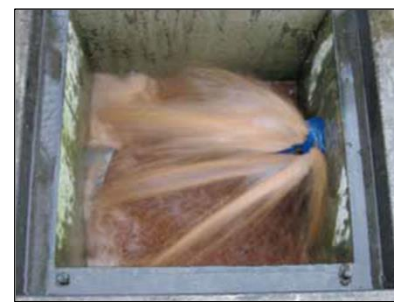
地震の影響で茶色く濁った水道原水である地下水（普段は濁っていない）
