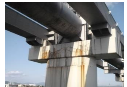
水管橋 橋脚のひび割れ
