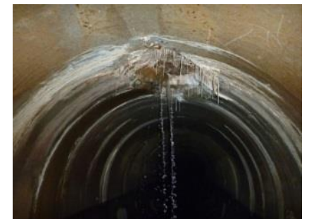
トンネル天頂部の欠損
