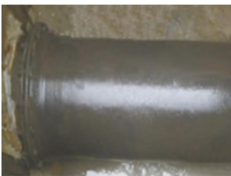
装着管の状況（腐食性土壌36年経過）
