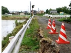
クリーク法面崩壊
