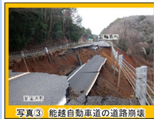
写真③ 能越自動車道の道路崩壊
