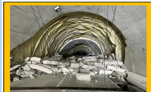
写真① 国道249号大谷トンネル内の崩落
