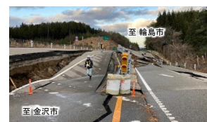
写真④ のと里山海道(越の原IC付近)道路崩壊 (R6.1.2撮影)
