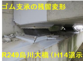
橋脚基部の損傷
