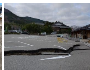
駐車場のクラックによる段差
