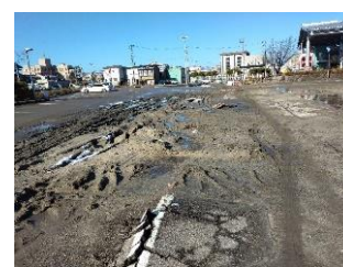
駐車場の液状化
