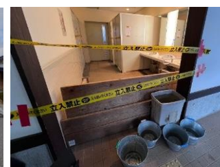
建物(トイレ等)の被災
