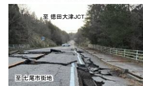
写真⑥ 国道249号(現道活用区間)道路崩壊 (R6.1.1撮影)
