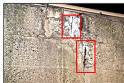
図4 擁壁のコンクリート剥離及び、鉄筋腐食
