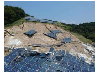
土砂崩れで生じた崩落
