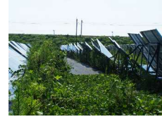
不十分な管理で放置されたパネル
